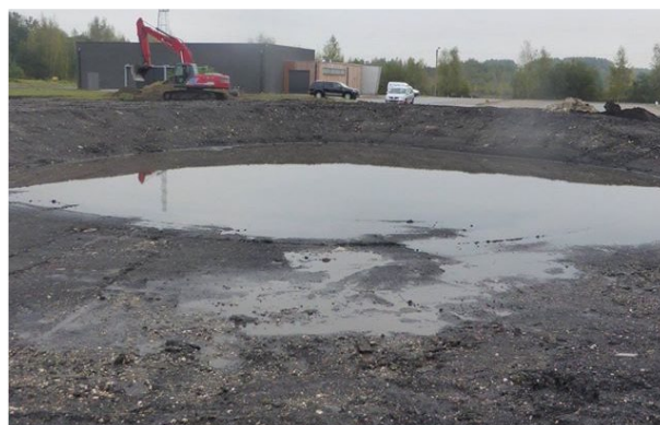
Mare de compensation aménagée sur un terrain de la ville de Mons à Havré
